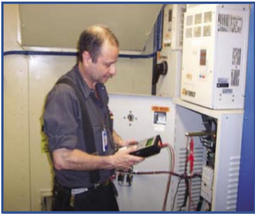
Una prueba de 2 minutos desde CCM evalúa las bobinas, cableado y conexiones a través de varios metros de cable!
