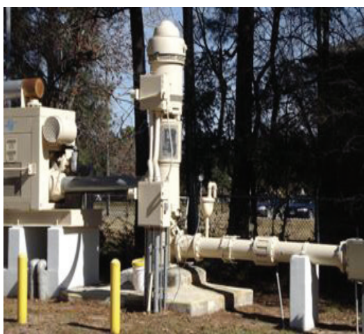
Instalación de bomba vertical para pozos profundos y motor de 400 Hp en el Pozo de Bombeo-1
